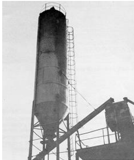
Figura 2. Silo de cemento equipado con escala de "gato"
